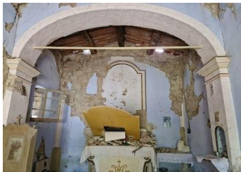
La chiesina di villa Perlungo: crepe sui muri e macerie cadute fin sull'altare
